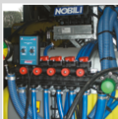
Gruppo comando elettrico 5 vie volumetriche con pulsantiera in cabina
